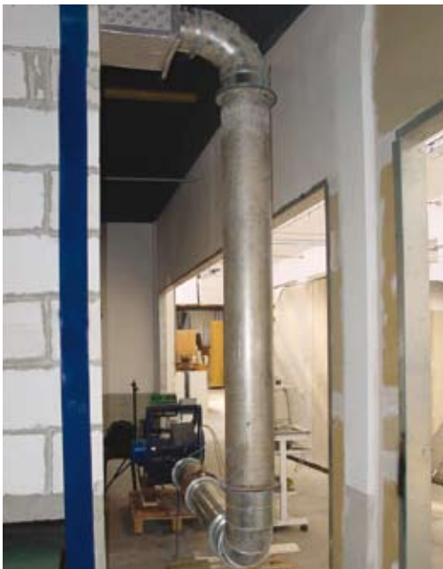
Fig. 10 - Detalle del sistema de ventilación
